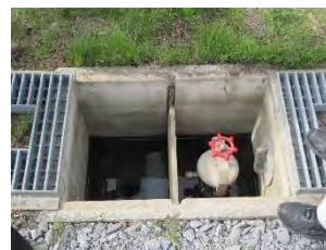
地下水位制御システム（管理ユニット）
