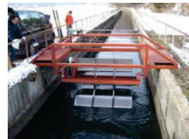
流水利用型発電機の設置状況
