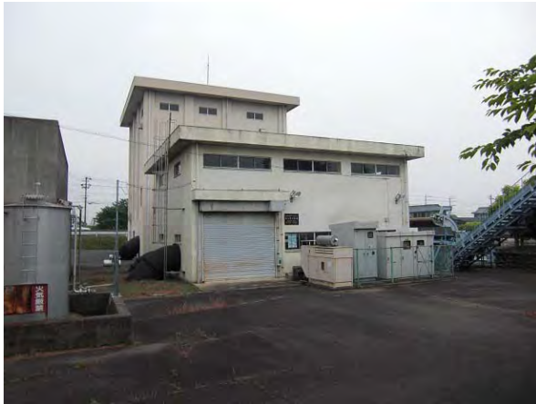
大島排水機場
