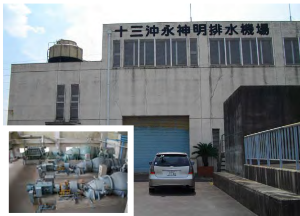
ポンプ 十三沖永神明排水機場
