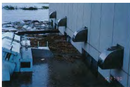
甲田揚排水機場の浸水状況 (平成2年10月27日)
