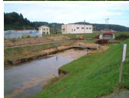
甲田揚排水機場 (平成16年10月1日) 豪雨により、幹線水路にわらが 流入する状況
