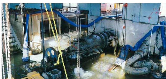
入沼排水機場内の浸水状況 (平成2年10月27日)
