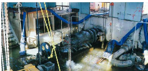
d 排水機場内の浸水状況
