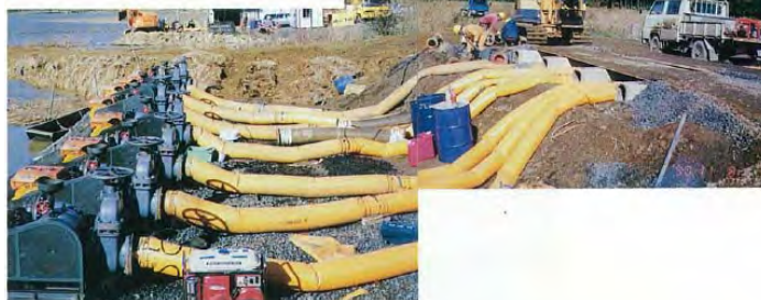
応急排水ポンプの稼動状況 （e 排水機場）
