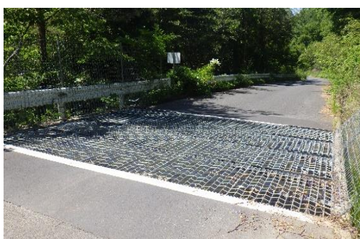
鳥獣被害対策（グレーチング）
