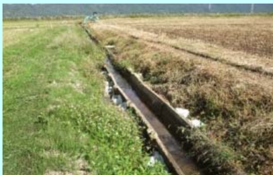
老朽化している用水路
