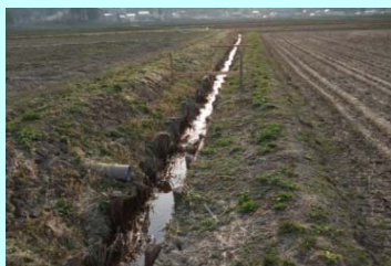
老朽化した水路
