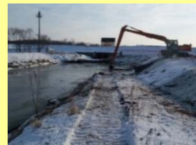
沈砂池の泥上げ (3年に1回(沈砂池数7))
