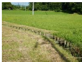
景観に配慮した木柵水路
