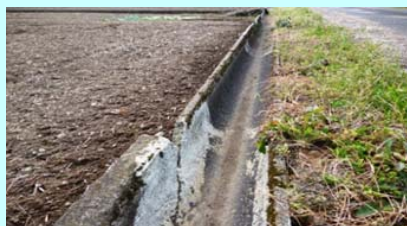
老朽化した水路
