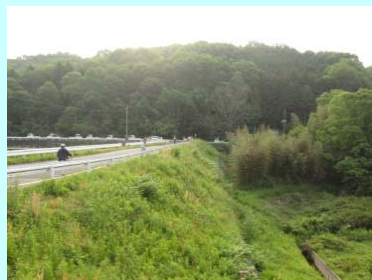
雑草や雑木が茂った堤体
