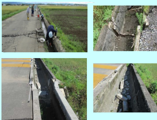
水路の損壊等の状況
