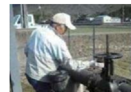
ポンプの点検状況
