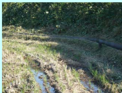
【老朽化水路からの漏水状況】
