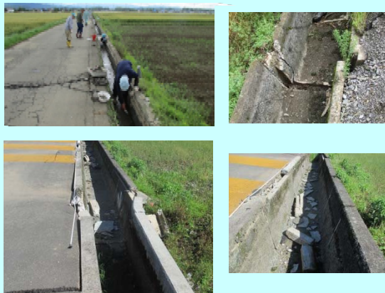
水路の損壊等の状況
