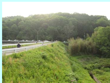
雑草や雑木が茂った堤体
