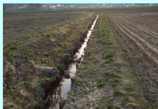
老朽化した水路
