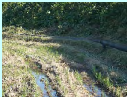
【老朽化水路からの漏水状況】
