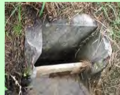
堰板による田んぼダム
