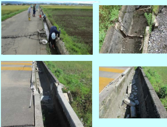
水路の損壊等の状況
