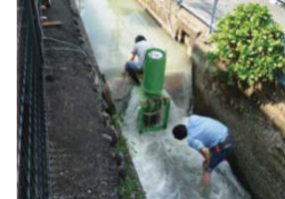
小水力発電機「彦電」
