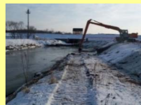
沈砂池の泥上げ （3年に1回（沈砂池数7））
