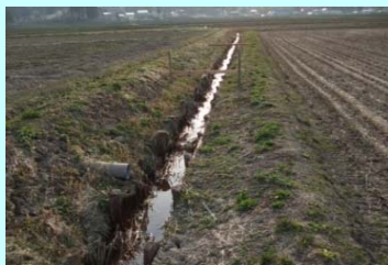
老朽化した水路
