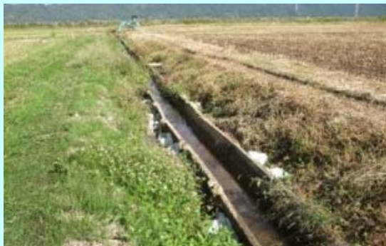
老朽化している用水路
