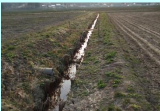
老朽化した水路
