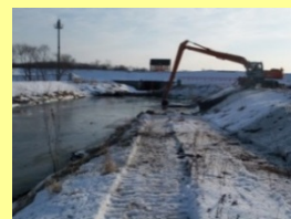
沈砂池の泥上げ （3年に1回（沈砂池数7））
