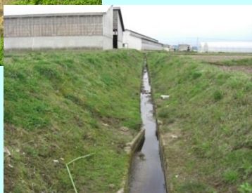
水路側壁の倒壊
