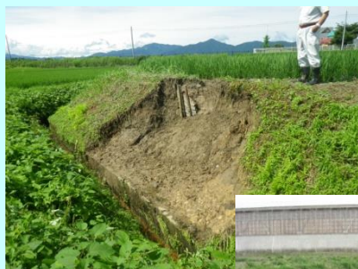
水路法面の崩壊
