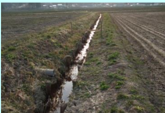
老朽化した水路
