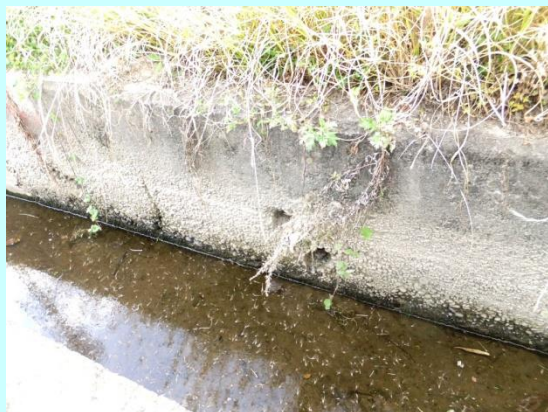
既設水路の劣化状況
