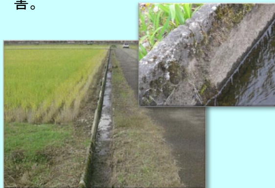
既設水路の劣化状況
