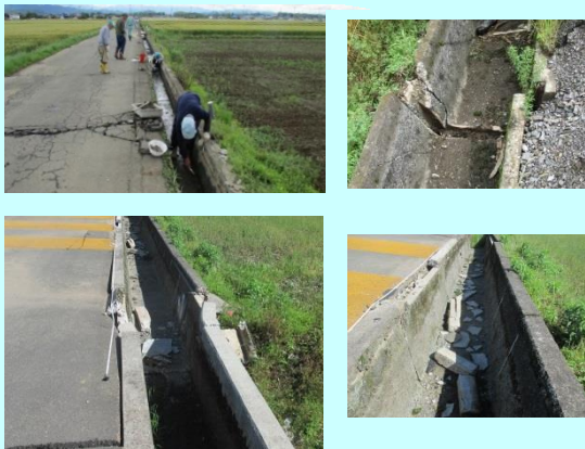
水路の損壊等の状況
