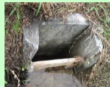
堰板による田んぼダム
