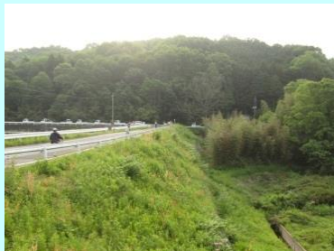
雑草や雑木が茂った堤体
