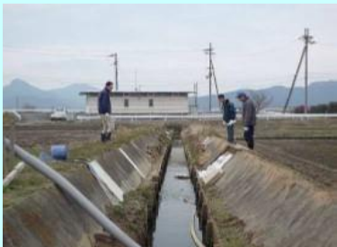
ほ場整備後の段差
