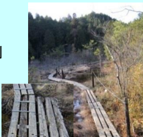
劣化の進行した木道
