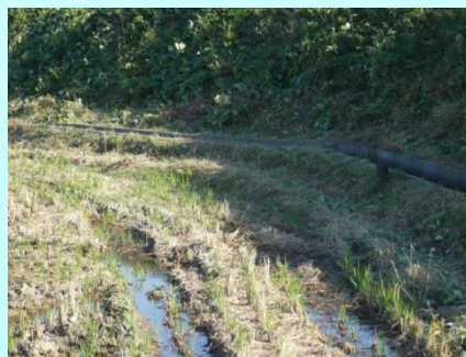
老朽化水路からの漏水状況
