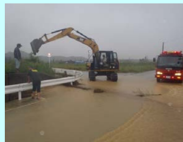
湛水確認後、応急措置として 土砂除去を実施
