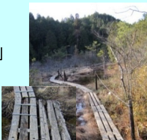
劣化の進行した木道
