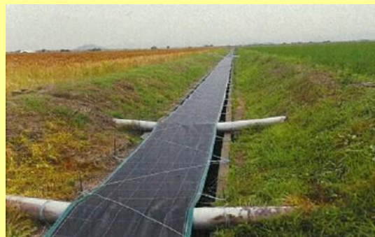
防草シートによる排水路の遮光
