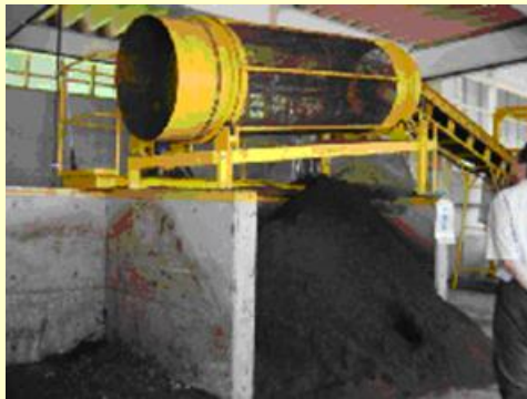
堆肥プラント
