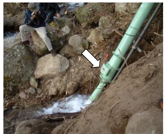
簡易な発電機（図の矢印）
