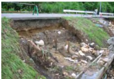
道路法面の崩壊状況
