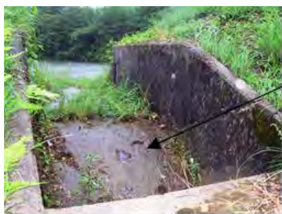
洪水吐底板（コンクリート）の欠損
