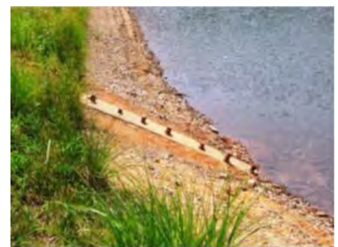
斜樋と取水栓
