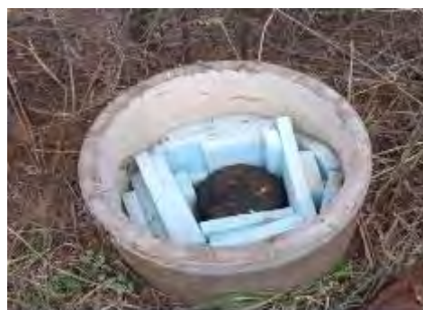
給水栓ボックス内の保温状況
