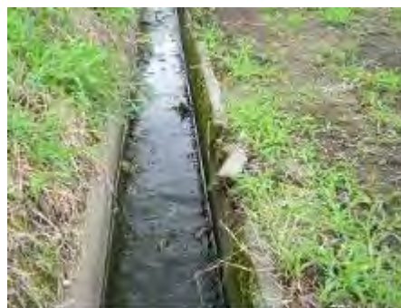
破損したU字溝
