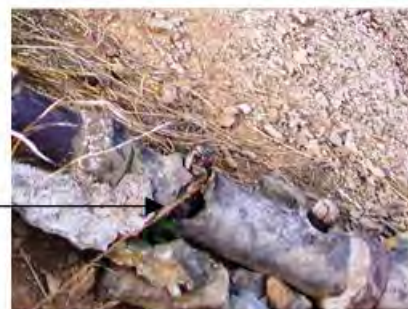
古い樋管（陶製）の破損
