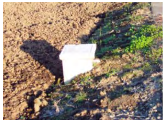
傾いた給水栓ボックス
