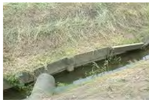
水路側壁のはらみの状況
