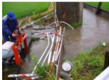
ゲートへのごみや流木の流入状況
