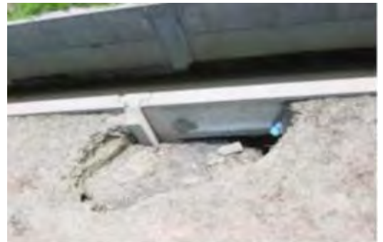
水路側壁の空洞状況
