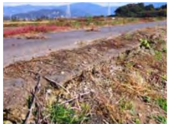
路肩の浸食と路面下の空洞
