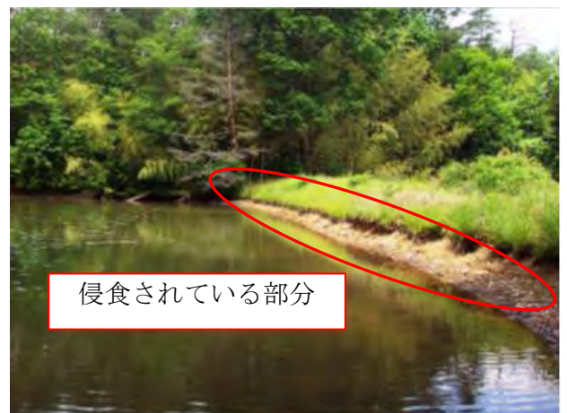
侵食が生じているため池堤体
