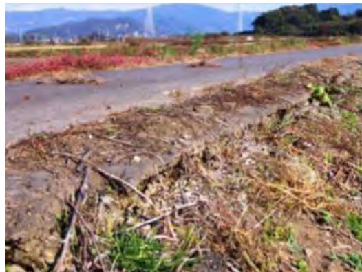
路肩の浸食と路面下の空洞
