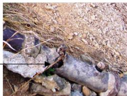
古い樋管（陶製）の破損
