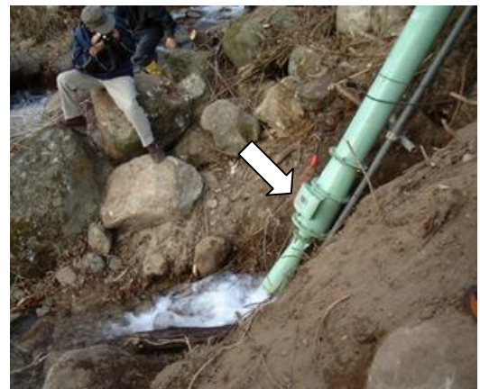
簡易な発電機（図の矢印）
