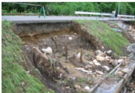
道路法面の崩壊状況
