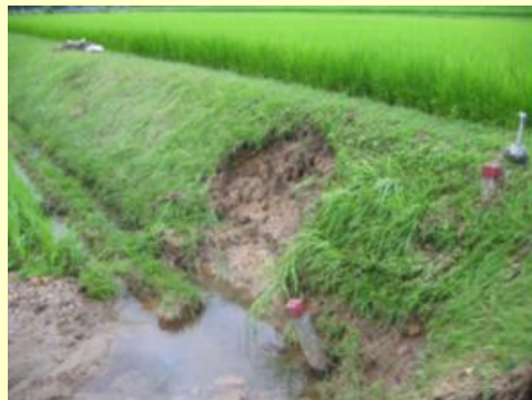
農用地法面が崩れた状況
