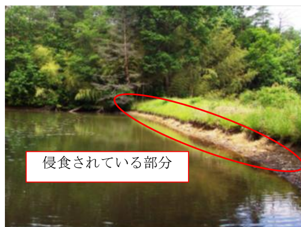
侵食が生じているため池堤体
