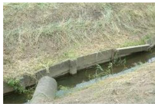
水路側壁のはらみの状況
