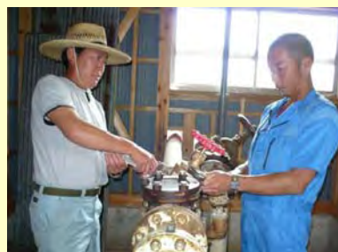
ポンプの点検状況
