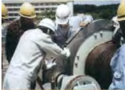
ポンプ点検状況
