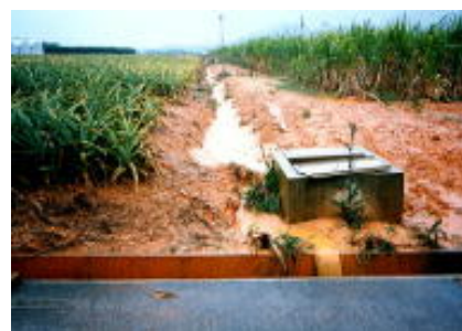
土砂の流出状況
