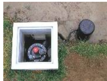
給水栓の自動化
