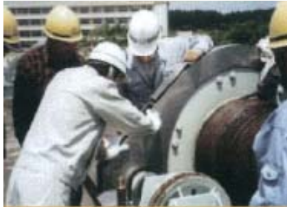
ポンプ点検状況
