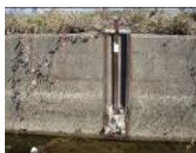
引き上げ式ゲート
