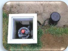
給水栓・取水口の自動化等
