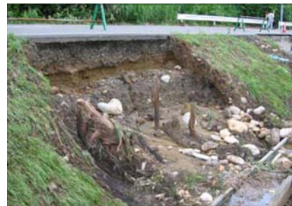
道路法面の崩壊
