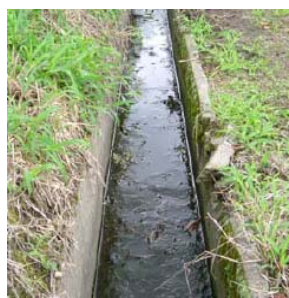
部分的な欠損
