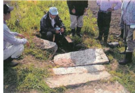
側溝蓋の損傷
