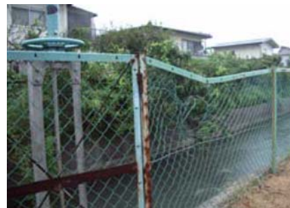
破損した金網フェンス
