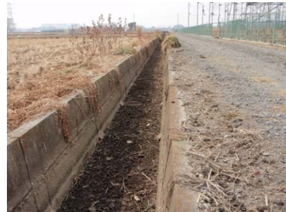
安全施設がない水路
