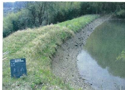
漏水が生じているため池
