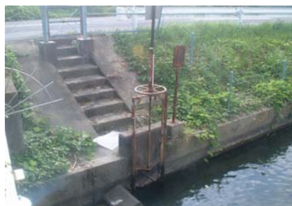
老朽化したゲート
