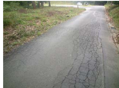
アスファルト舗装の 老朽化
