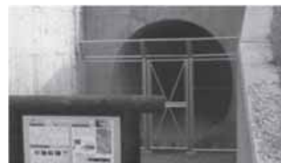
参考 2-19 バットゲートの設置状況
