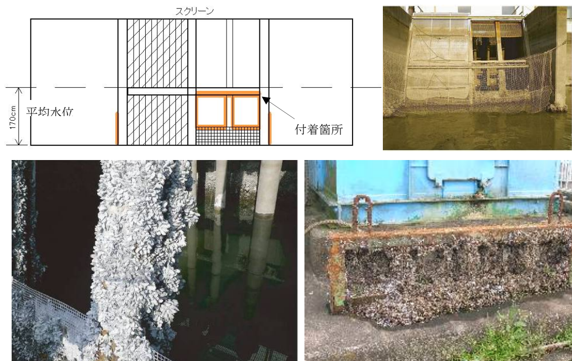
図 16 スクリーン内部での固着状況
