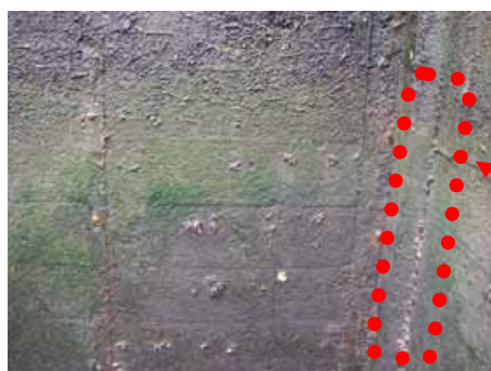
壁面の貝の付着状況
