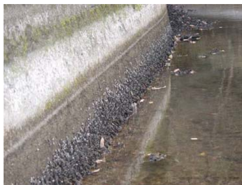
水路壁面への固着
