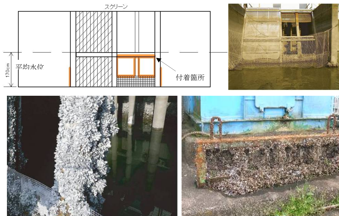
図 16 スクリーン内部での固着状況
