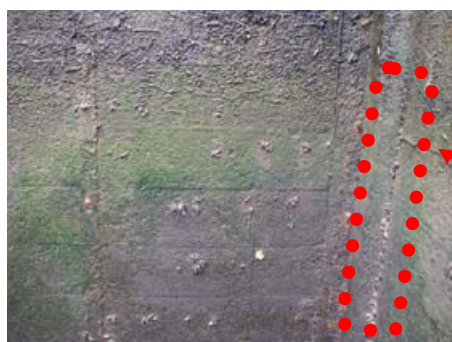
壁面の貝の付着状況
