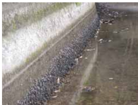
水路壁面への固着
