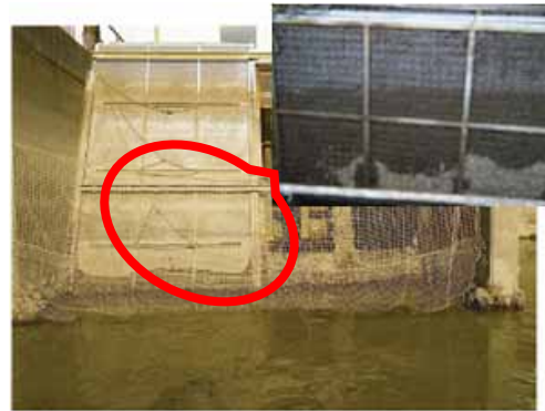
図 62 フレームに固定されたフィルター
