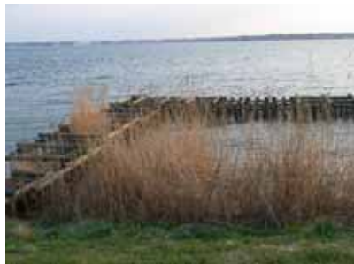
© JWRC 湿地を保護する防波柵
