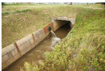
合流工（小排水路と支線排水路） における落差
