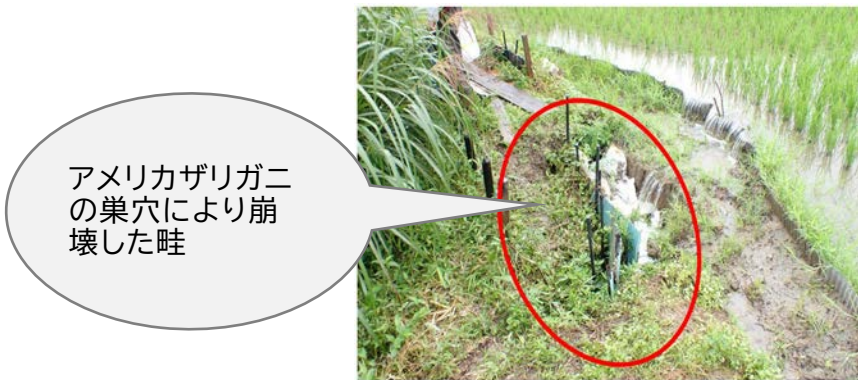
図 2-16 アメリカザリガニの巣穴による畦崩壊の事例(福岡県福津市) (農林水産省実証調査結果より)
