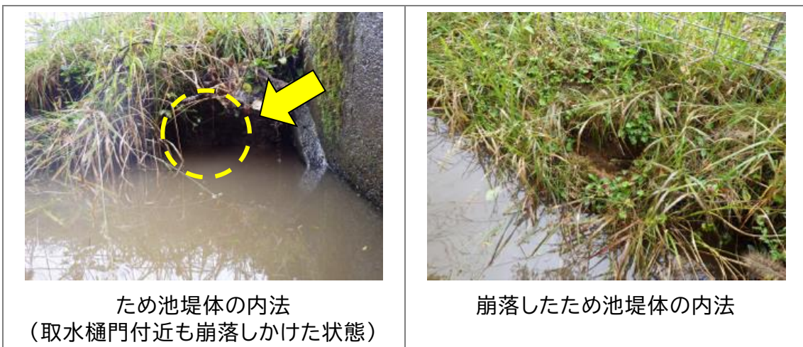
図 2-22 アメリカザリガニの巣穴により崩落した護岸(山口県山口市)
