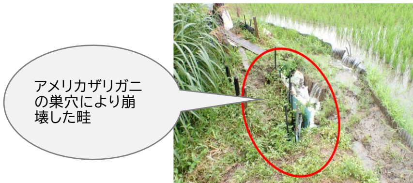
図 2-16 アメリカザリガニの巣穴による畦崩壊の事例(福岡県福津市) (農林水産省実証調査結果より)
