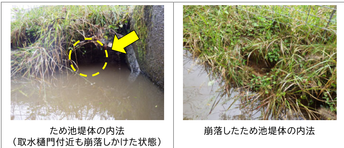
図 2-22 アメリカザリガニの巣穴により崩落した護岸(山口県山口市)
