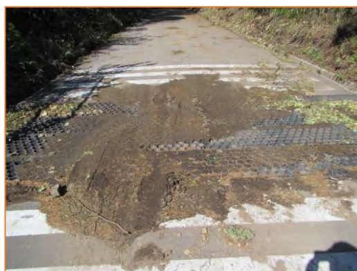
台風による土砂流入により 機能を失ったグレーチング
