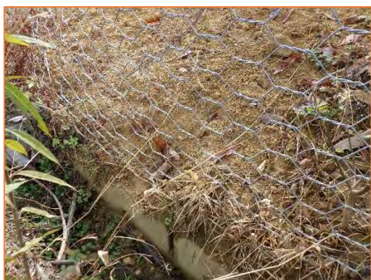
侵入防止柵下部の掘り返し例
