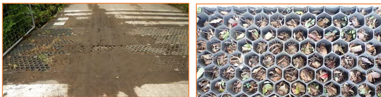
土砂（左）や落葉（右）によるグレーチングの目詰まり例
