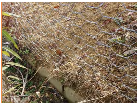
侵入防止柵下部の掘り返し例
