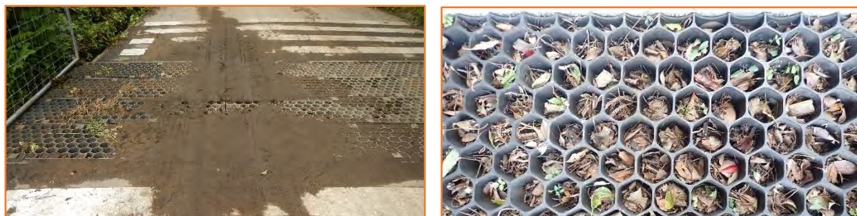
土砂（左）や落葉（右）によるグレーチングの目詰まり例
