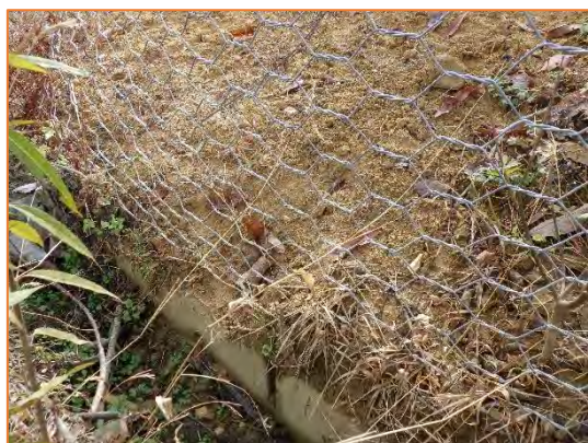
侵入防止柵下部の掘り返し例
