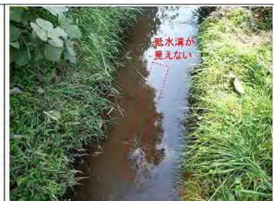
【否】過剰な土砂堆積量で埋没した深み（低水溝）OS-7
