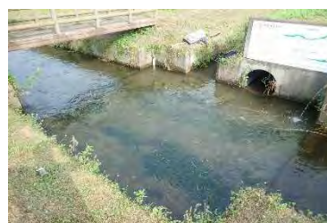
水路魚道の下流端に配置された集水柵
