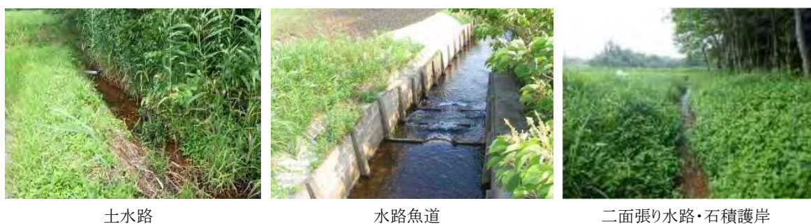
図 3-42 G 地区に設置された生態系配慮施設
