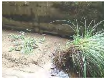
土砂に埋没した魚巣ブロック
