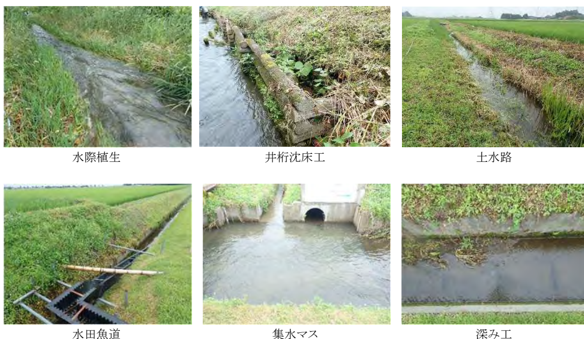
図 3-31 A 地区に設置された生態系配慮施設
