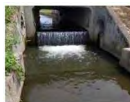
図6 St. 29：上下流部の分断
