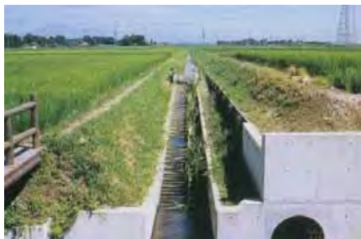
幹線排水路と土水路を連結するための小規模な魚道 (千鳥X型) (栃木県)。
